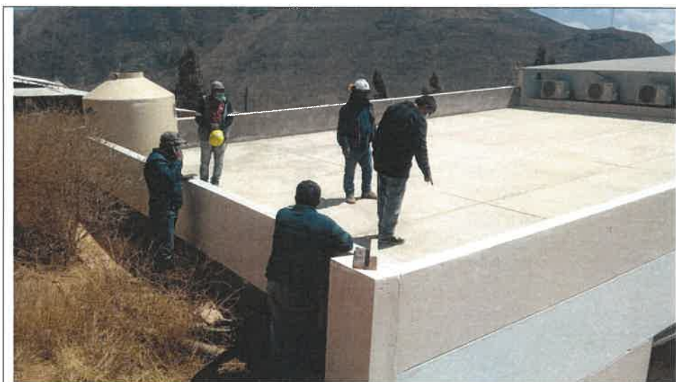
Visita de inspección de trabajos a nivel de vicios ocultos entre el consorcio SAN PEDRO y representantes de la UNAAT.
