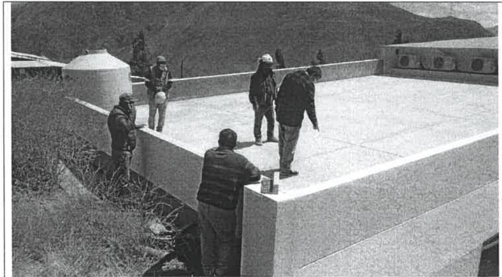
Visita de inspección de trabajos a nivel de vicios ocultos entre el consorcio SAN PEDRO y representantes de la UNAAT.
